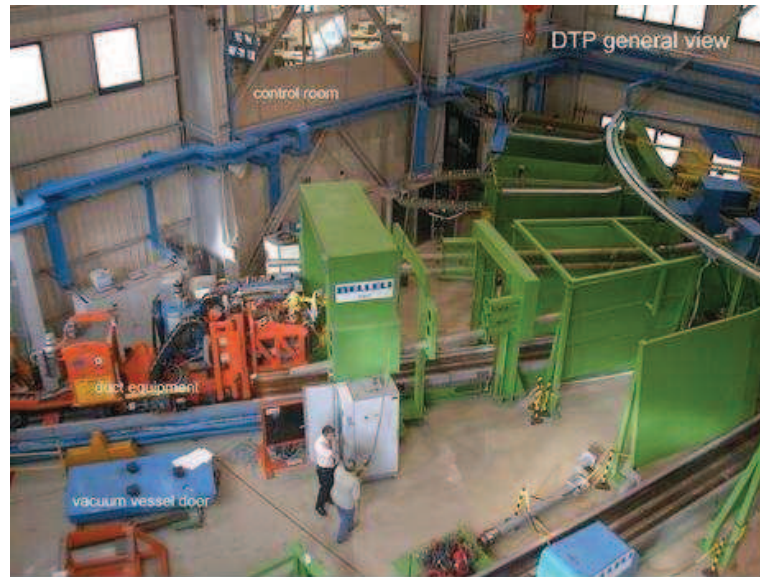
Figura 9.8. Vista general de la instalación DTP 145 del Laboratorio de manipulación remota de ENEA.
